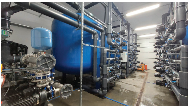
Instalacja uzdatniania wody w Świętoniowej
