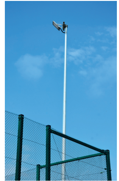
Oświetlenie boiska wielofunkcyjnego w Chałupkach
