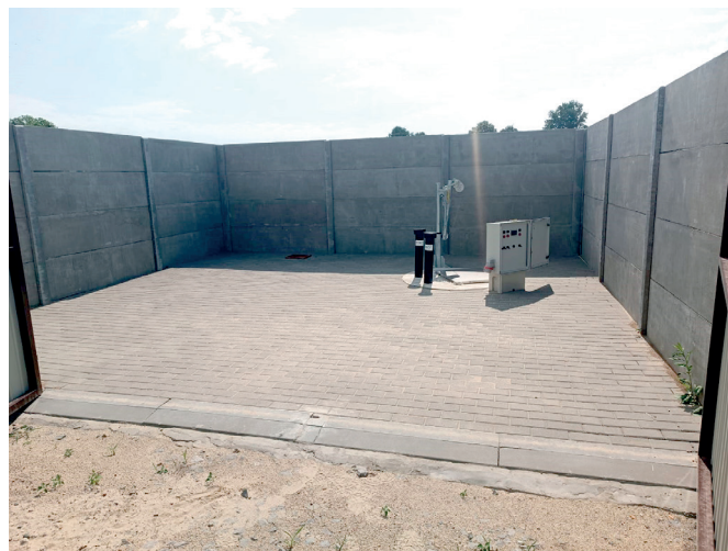
Przepompownia ścieków w Świętoniowej
